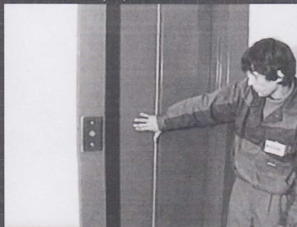
ПРОВЕРКА АВТОМАТИЧЕСКОГО ЗАМКА ДВЕРИ ШАХТЫ
